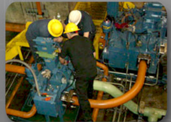
Entretien des installations hydrauliques et mécaniques
